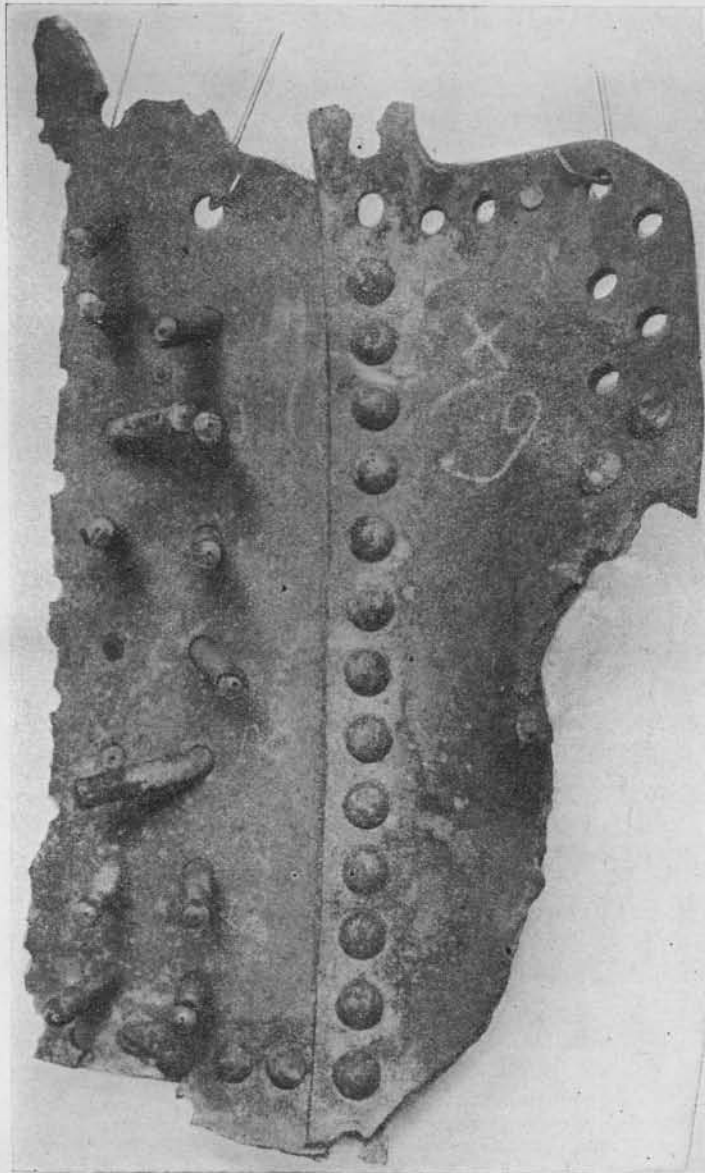
Fig. 2. — Photographie du panneau vu de l'intérieur de la chaudière.
